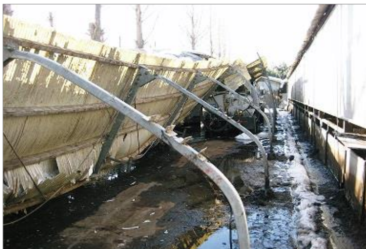
写真2 崩れた車庫と下敷きになった車両
