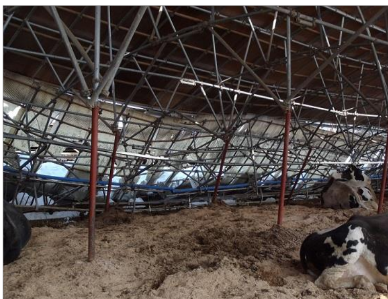
写真1 牛のすぐ近くに落下した牛舎の天井
