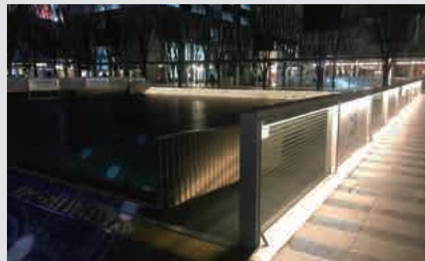
▲手すりに設置された照明
