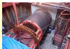
下水道施設の耐震
