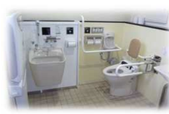
障害者対応型トイレ
