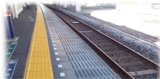
内方線付き点状ブロック
