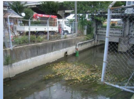
導水管及び揚水ポンプ設置状況 (見沼代用水東縁)
