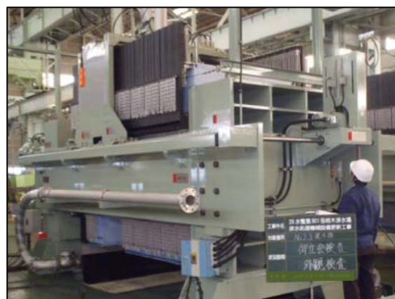
機械設備（脱水機）
