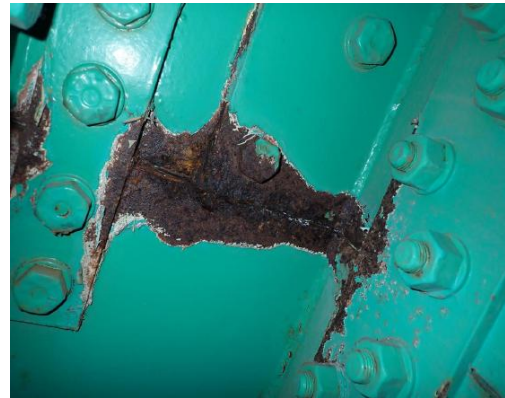
劣化状況（朝霞陸橋）
