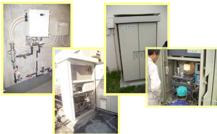
写真8：自動水質監視装置
