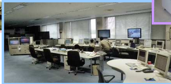
写真6：浄水場中央管理室 （行田浄水場）
