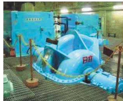
大久保浄水場の送水ポンプ
