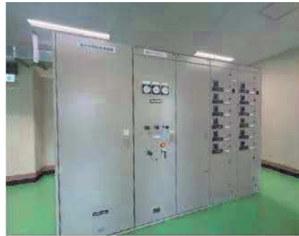
行田浄水場新着水井電気設備
