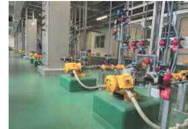
次亜注入ポンプの設置状況
