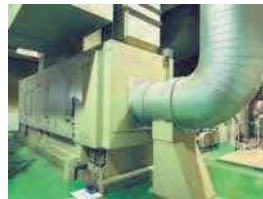
自家発電設備
