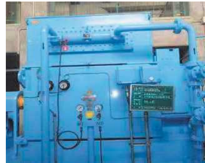
中継ポンプ電動機
