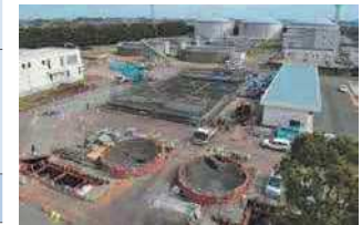
行田浄水場着水井
