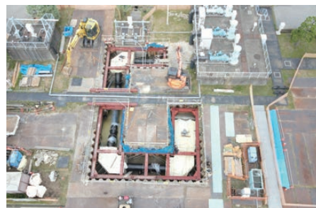
柿木浄水場場内連絡管
