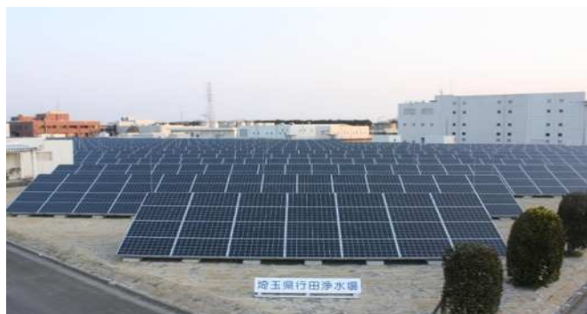
写真6 行田浄水場の太陽光発電（メガソーラー）
