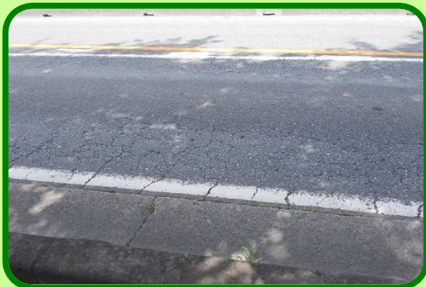
舗装の修繕前
