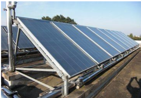
太陽熱給湯設備
