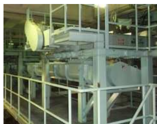
新河岸川水循環センター 汚泥搬送設備
