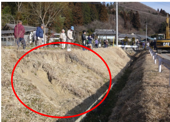
【水路法面の崩落状況】
