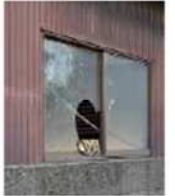
窓が割れた 管理不全空家
