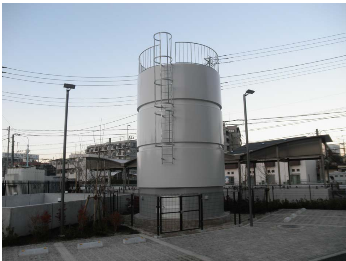
【上：二槽式・下部ポンプ室付受水槽】
