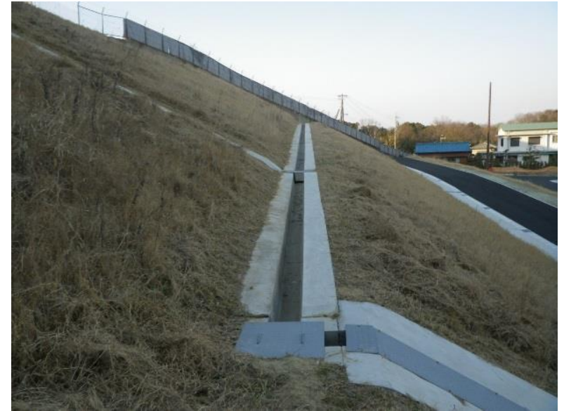
法面排水の例
