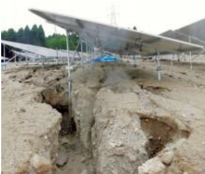
雨だれによる洗堀 杭基礎が露出
