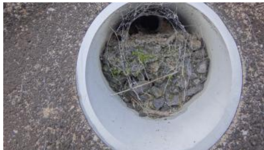
水抜き穴の詰まり
