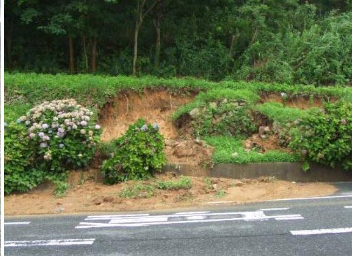
小規模な崩壊が隣接する法面で発生：※
