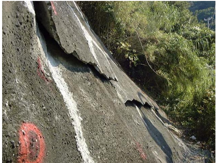
新しい吹付工に水平方向に延び、せり出し状態の亀裂が発生：※
