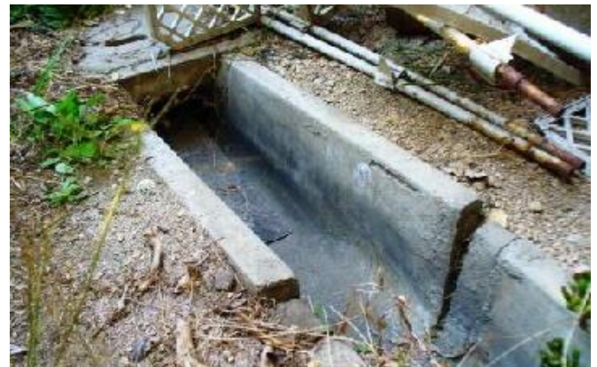
垂直方向への折れ曲がり：※
