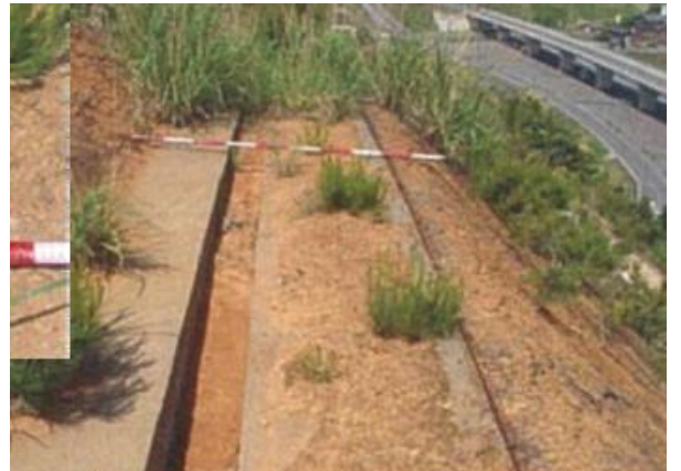
法面排水溝への土砂等の堆積：※
