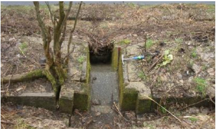
木の成長により側溝が破損し漏水する状態：※
