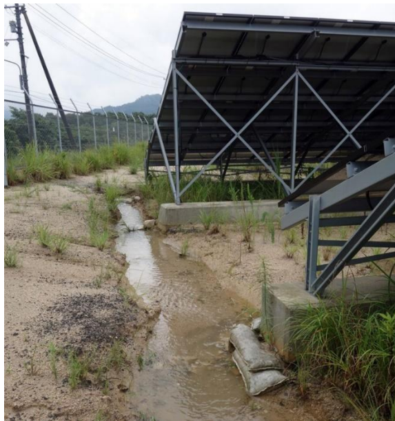
洗堀による自然水路 フーチング下まで洗堀
