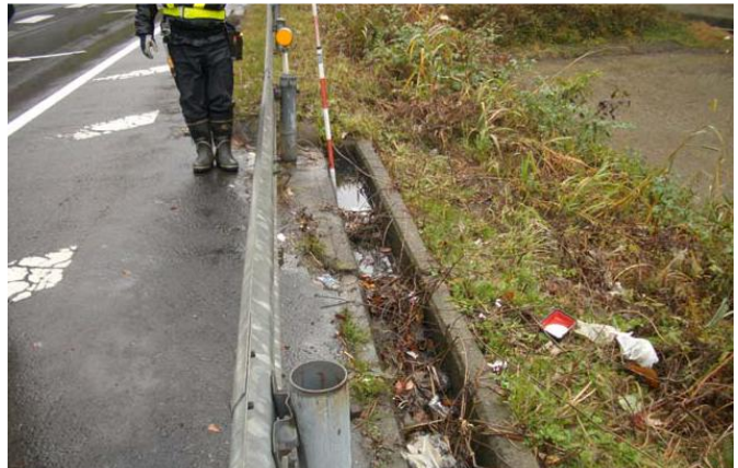
側溝にゴミが堆積し水溜や水もれがある状態：※
