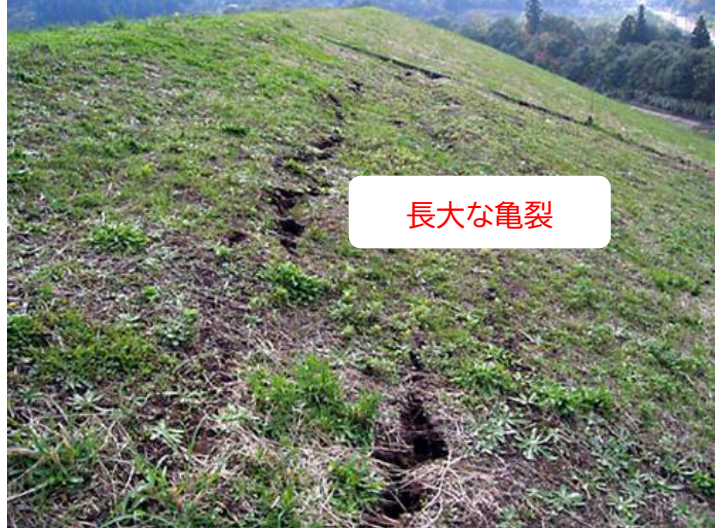
長大な亀裂（クラック）が法面上に水平方向に発生
