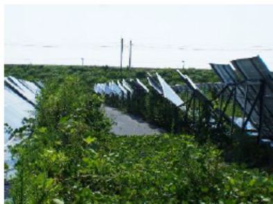
不十分な管理で放置されたパネル
