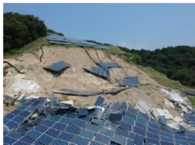
土砂崩れで生じた崩落
