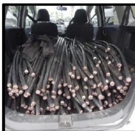
窃取された銅線ケーブル
