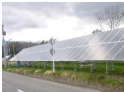
柵の設置されない設備
