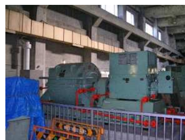
中川水循環センター 送風機
