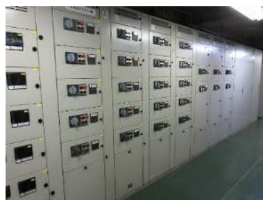
新河岸川水循環センター 水処理電気設備
