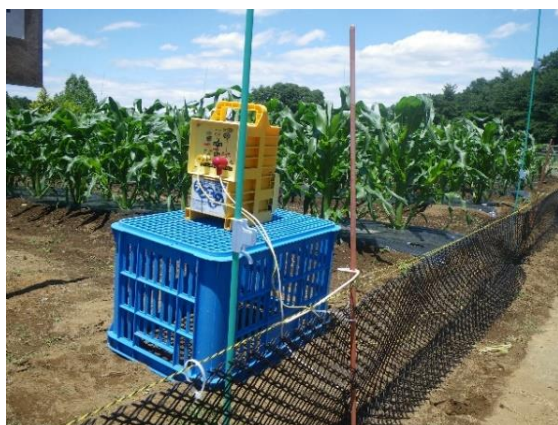
図18 電源本体は柵内部に設置
