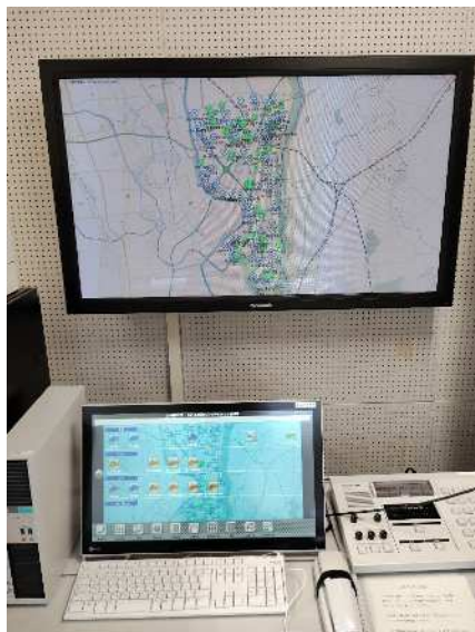
更新した防災行政無線 放送機器
