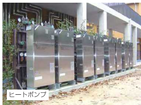
写真 11 (上) 表示パネル (下) ヒートポンプ
