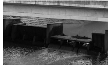
写真3 堰の状況 (9月4日、転倒後)
