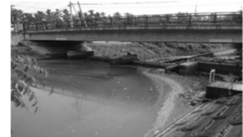
写真 1 貯留水の状況
