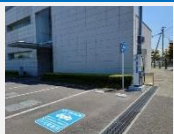
上里町役場EV充電スタンド
