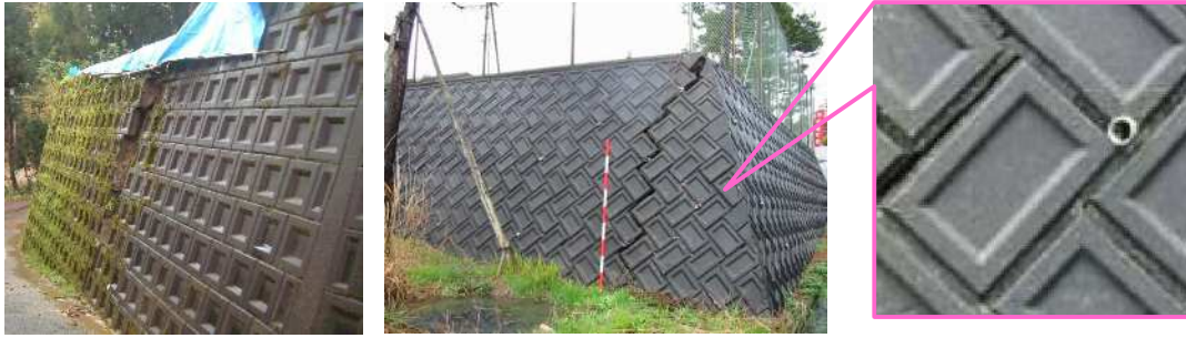
(a) 水抜穴が無い前傾した擁壁 (b) 水抜穴が 20 mm と小さい事例
