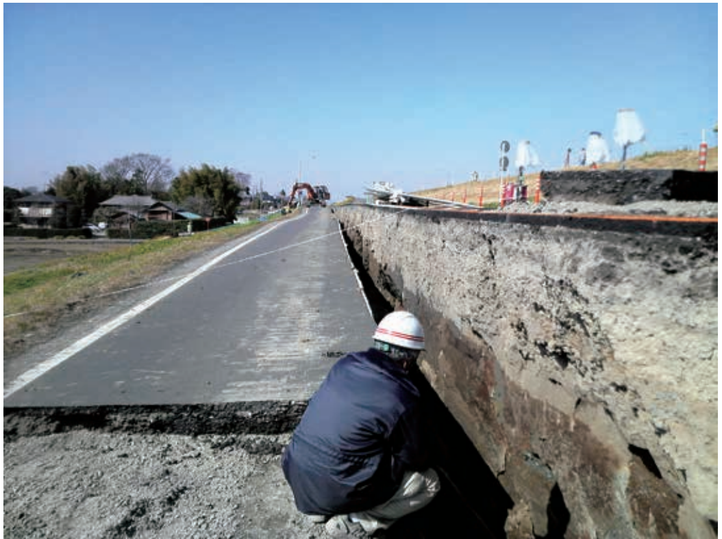
東日本大震災で片側車線が大きく陥没した道路
