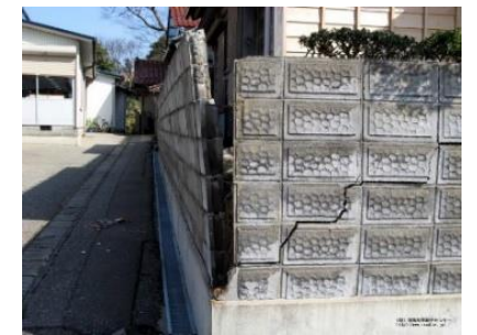
出典：(一財)消防防災科学センター 塀の被害事例
