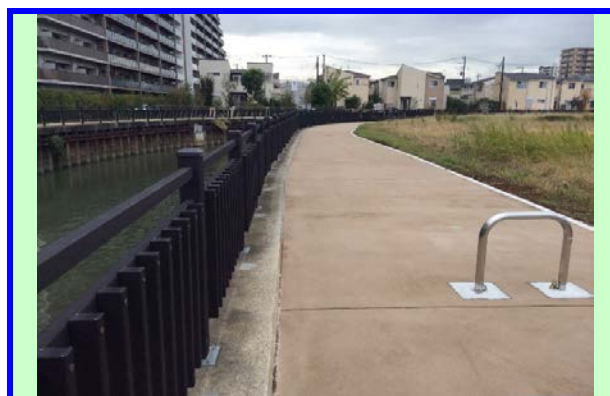
総簡加) 社会資本整備総合交付金(河川)工事(遊歩道整備工)(伝右川)
